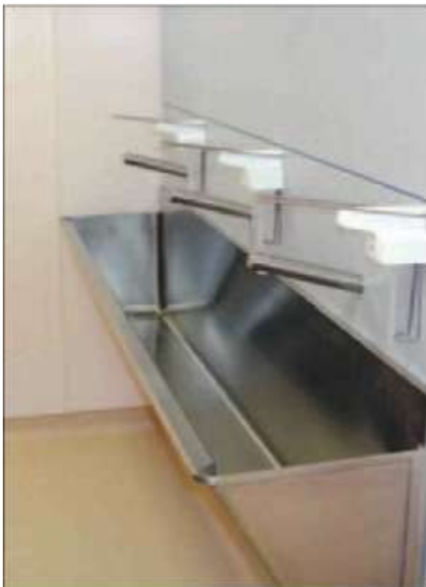
Figura 8 Chiuvetă cu robinete senzor perete pentru șervete de hârtie.
